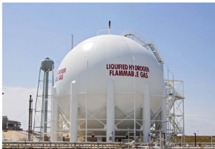
图 5-8 球形液氢储罐
